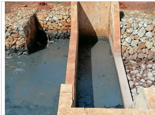
Figura iv. Exemplo bacia de sedimentação existentes
